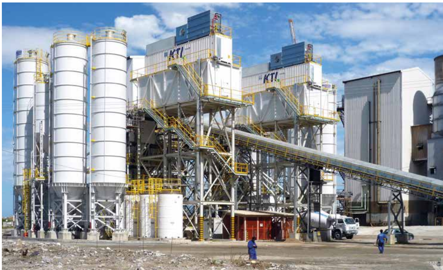
Die Kälteanlagen von KTI werden unter anderem wie hier weltweit in Großanlagen zur Betonkühlung eingesetzt
